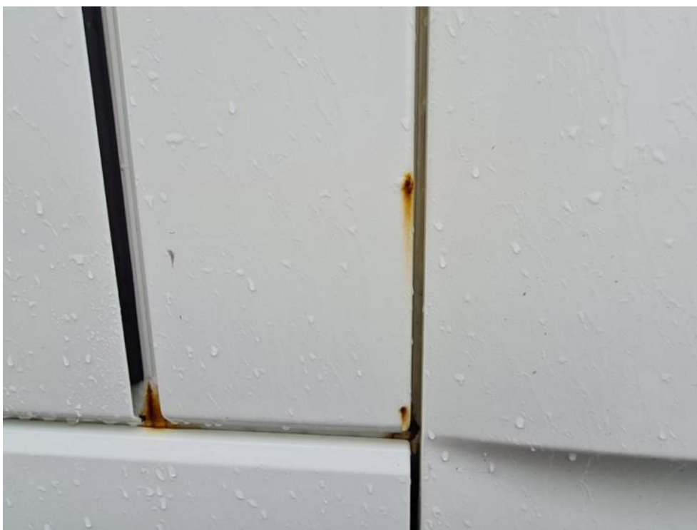
Fot. 45. ściana boczna L
