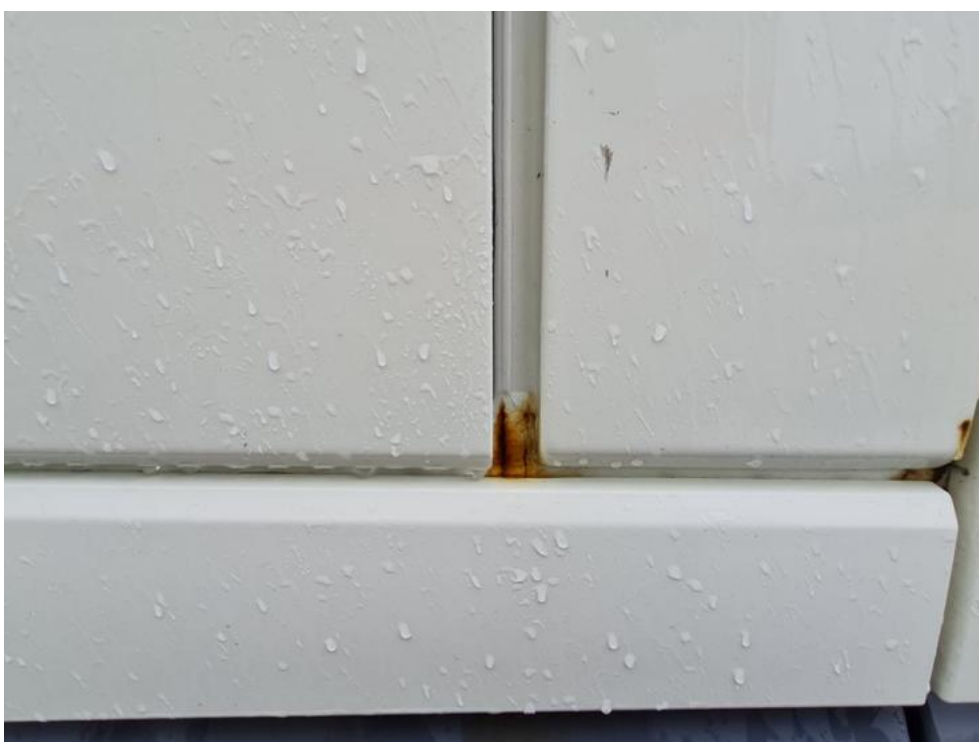
Fot. 44. ściana boczna L
