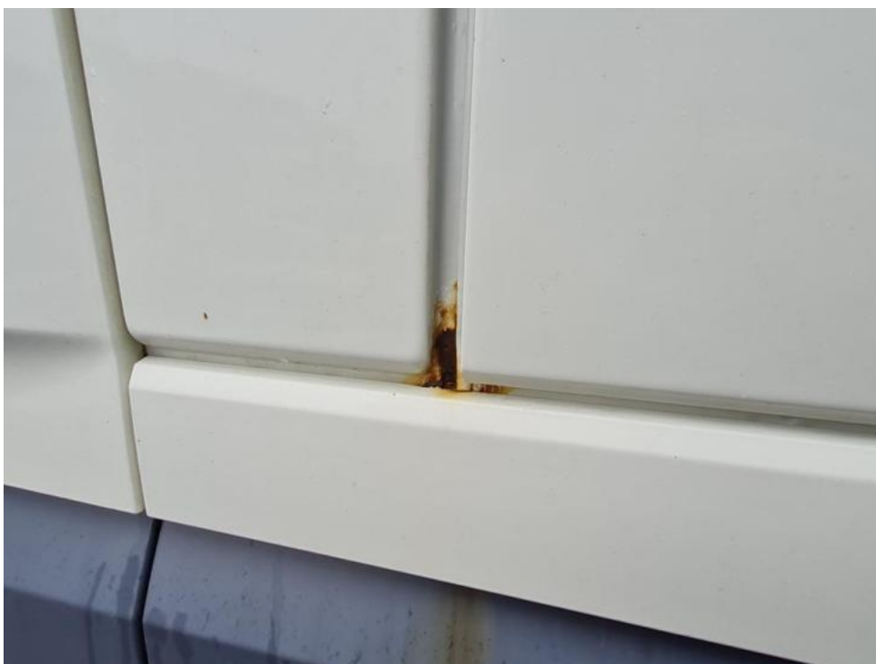
Fot. 63. ściana boczna P
