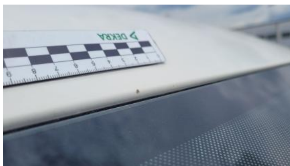
Fot. 38 Dach - Rysa/odprysk 1
