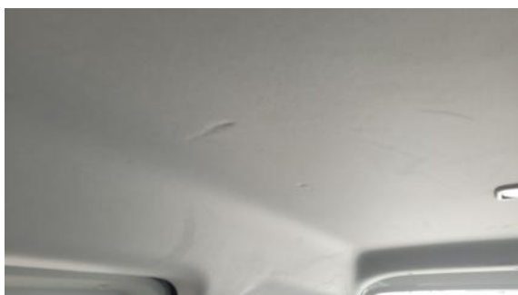
Fot. 37 Podsufitka - Wgniecenie/odkształcenie 1
