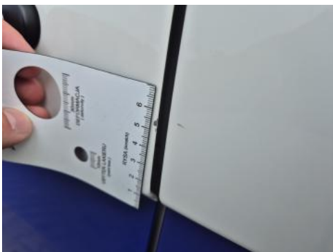
Fot. 39 Drzwi przed L - Rysa/odprysk 1
